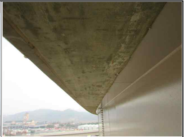
바닥판 하면 캔틸레버부 상태양호
