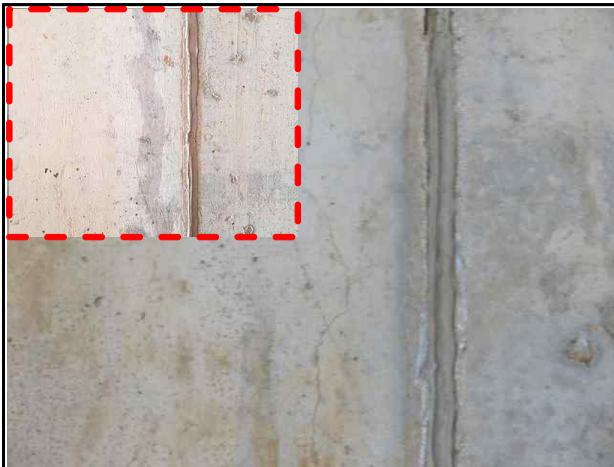
교대 A1 균열(폭 0.1mm)(보수완료)
