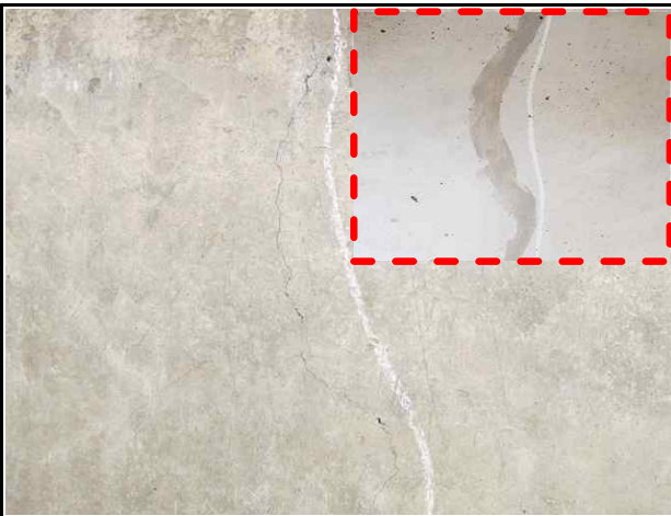
교각 균열(폭 0.1mm)(보수완료)
